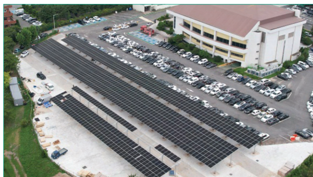
주차장 태양광 구조물
